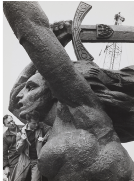
Montaż pomnika Bohaterów Warszawy (Warszawska Nike) Fot. Edward Hartwig Czas powstania: 8 [ósmego] lipca 1964 [tysiąc dziewięćset sześćdziesiątego czwartego] www.kolekcje.muzeumwarszawy.pl/pl/obiekty/4067
